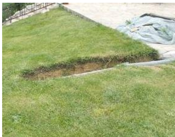
A megsüllyedt részüél
