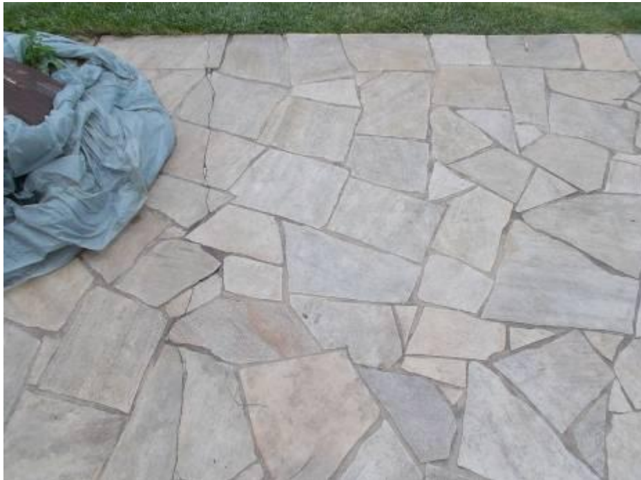
A megrepedt terasz burkolat
